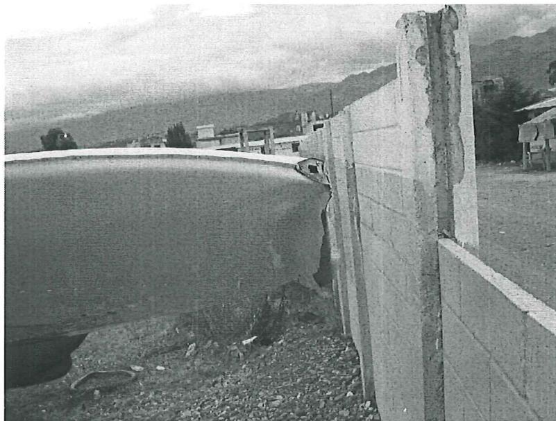
Una de las losas de las paredes se callo al se empujada por la punta del ala derecha.
